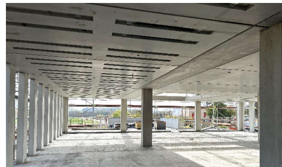
Abbildung 2: Deckenunterseite mit den Aussparungen für die Akustikabsorber
