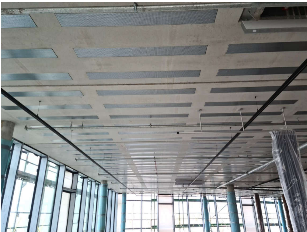
Abbildung 6: Deckenunterseite mit der Anordnung der Absorber
